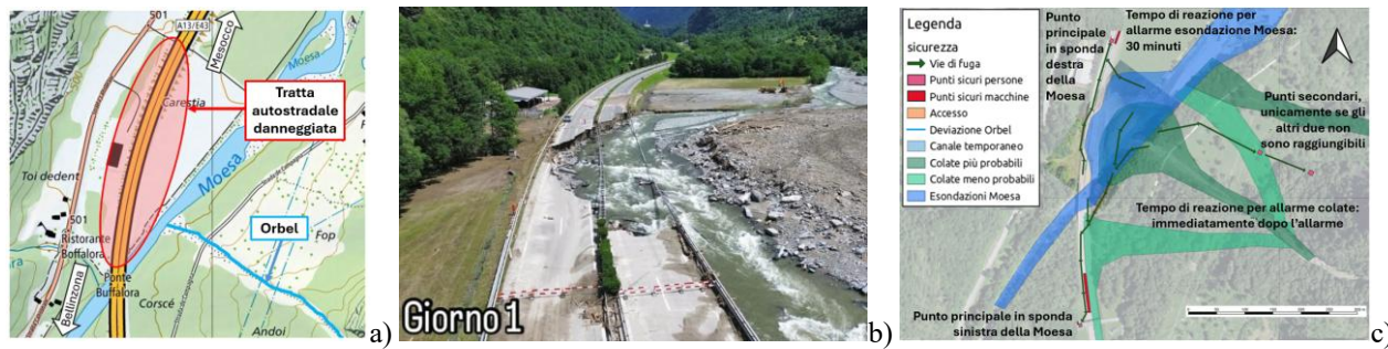
Figura 1. a) Tratta interessata dal collasso; b) vista aerea il 22/06/2024; c) piano di sicurezza interventi di ripristino.
