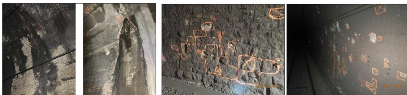
Figura 3. Principali tipologie di danni riscontrate nei Tunnel del 4mK, da sinistra a destra: incrostazioni, venute d'acqua, muratura rotta o sfaldata, vuoti a tergo della muratura (Merlini et al., 2025).
